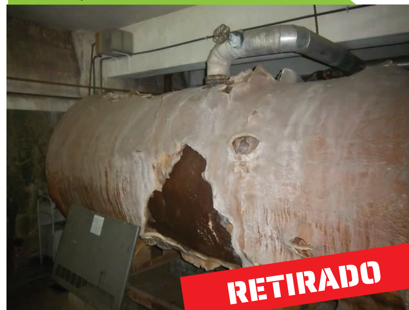
Caldera, Hospital de Salta
